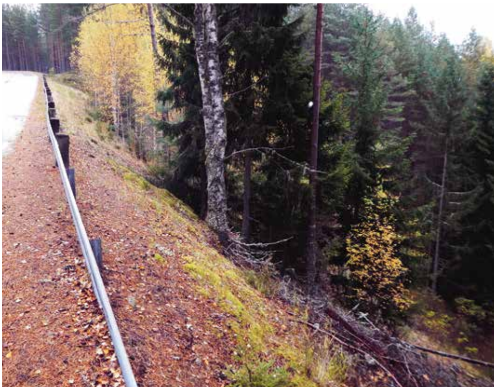
Figur 39. Vägbank med stark lutning.
