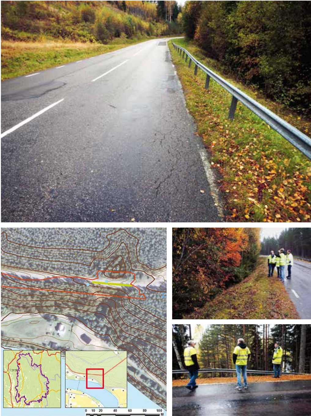
Figur 38. Område med hög vägbank inklusive indikation för trumma. Norr om vägen är ett djupt håll, vilket knappt går att skönja genom den täta skogen. Fotona är tagna på varsin sida om vägen. Bilden till vänster visar hur brant det är. I botten av hålet återfanns en igen rasad stentrumma.
