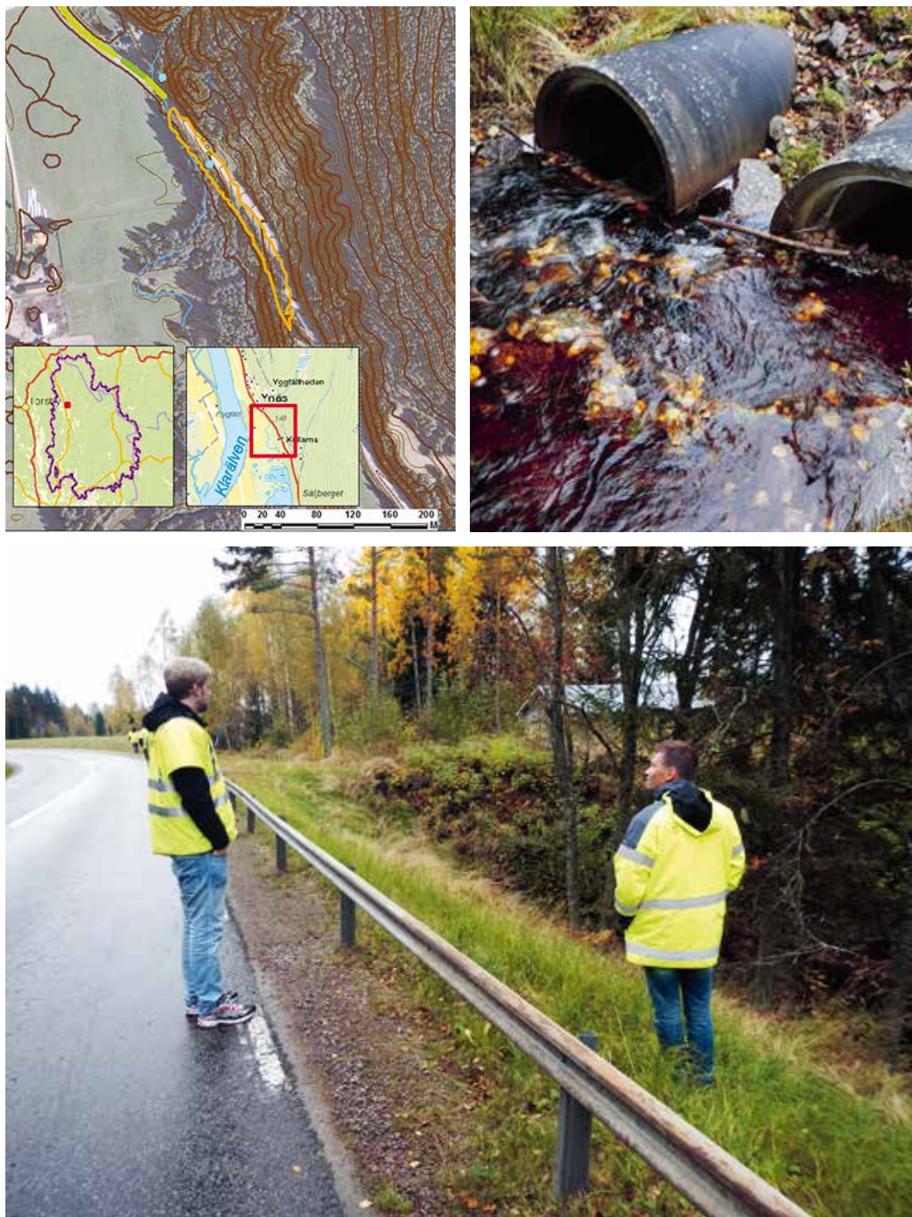
Figur 37. Exempel på hög vägbank i sluttning i kombination med nytt hygge (2007) i brant sluttande område med skredrisk. En dubbel trumma i norra delen av området, med flödande vatten, där ena trumman satts igen fullständigt.
