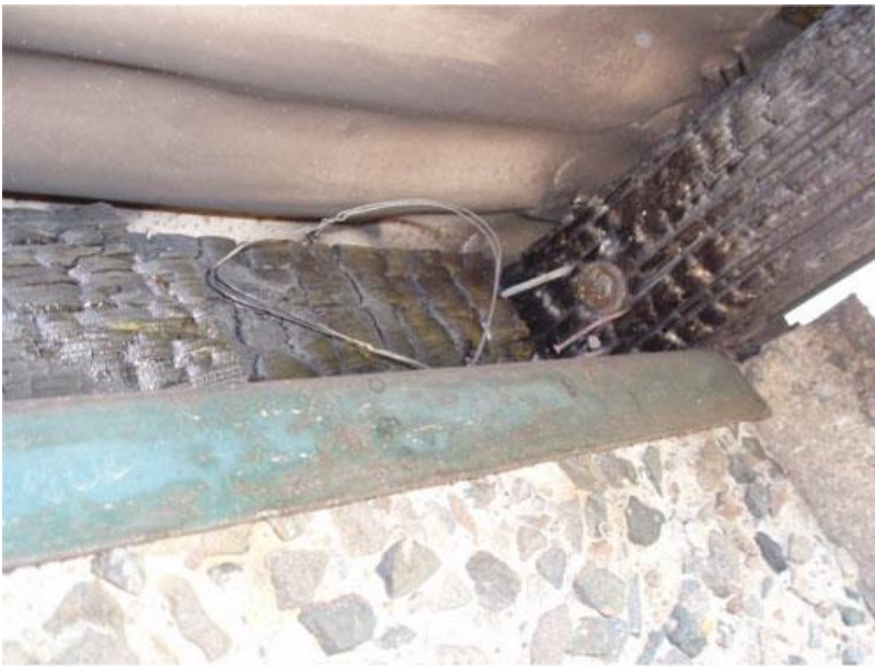
Bild 4: Kolningsskador takbjälke vid takfot
