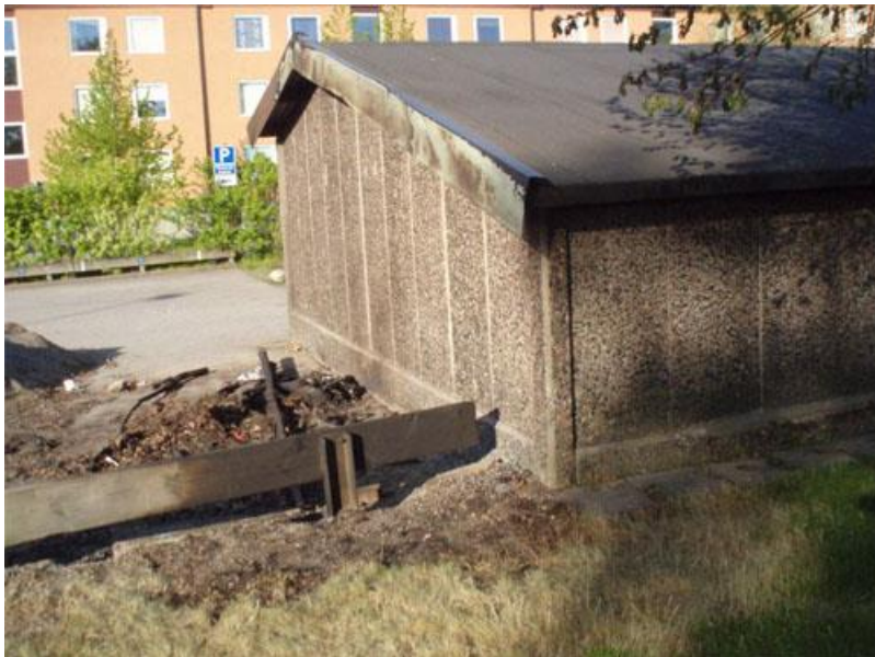
Bild 2: Mindre kolnings-skador på skydds-räcke.
