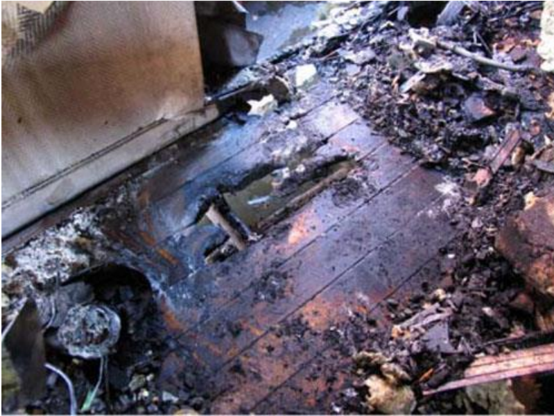
Bild 4 Genombränning av golv på primärbrandplats. Väggtugg där branden startade tidigare monterat på riven vägg.
