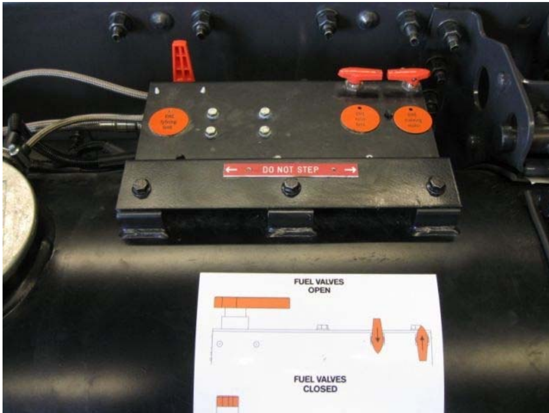
Bild 10, Ventiler på tank. Ventilerna är i avstängt läge på bilden.
