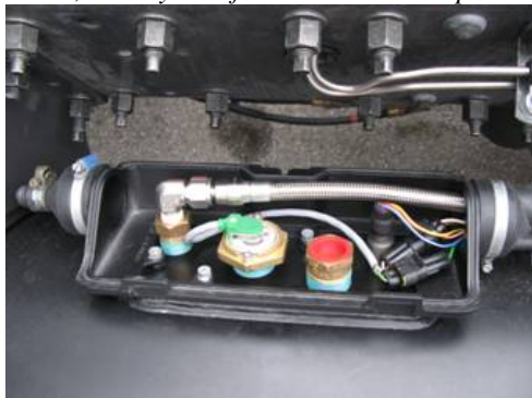
Bild 5, Säkerhetsventil med rött plastlock, nivåmätare till vänster om säkerhetsventilen
