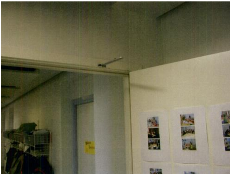
Avhakade dörrstängare i brandcellsgräns.
