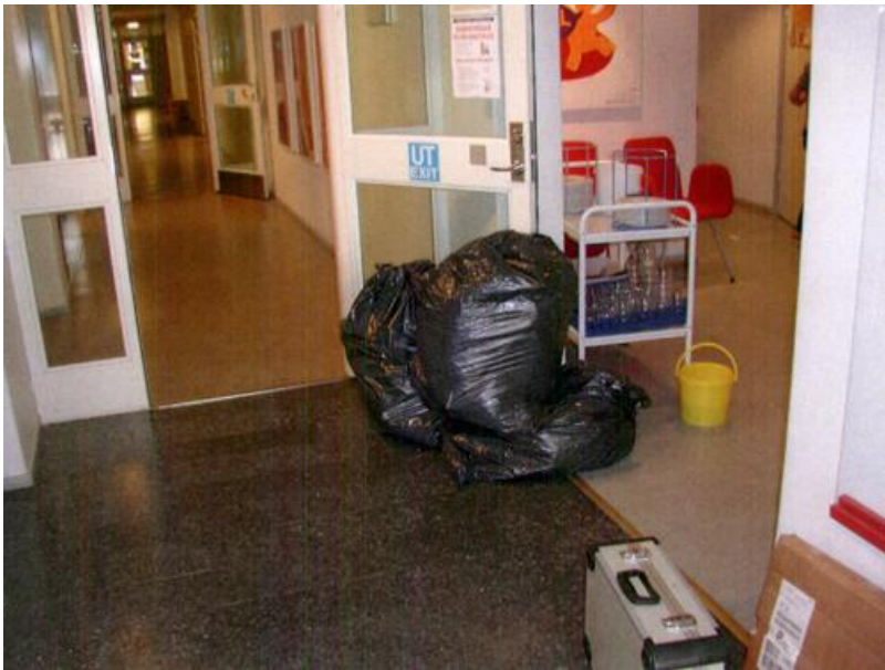
Uppställd dörr i brandcellsgräns.
