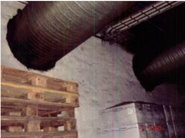
Genomföringar mellan brandhärjad del och produktionslokaler i byggnadens sydvästra del, byggnad B.
