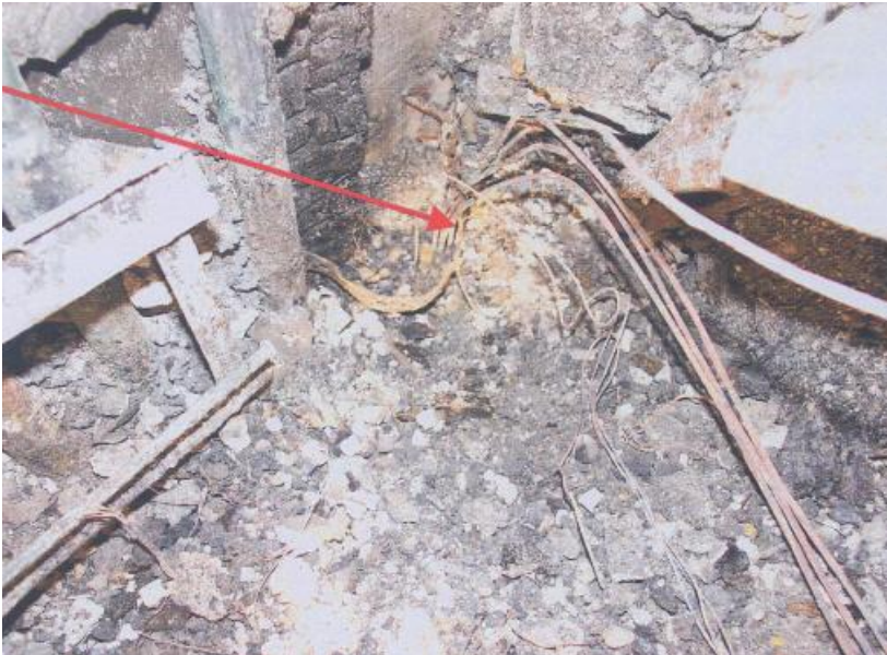
Bild 4. Bilden visar rester av matarkabeln.
