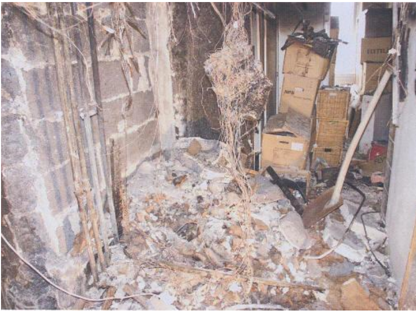
Mitt i bilden hänger resterna av en el-central. Högen som syns på golvet är den nedrivna väggen.
