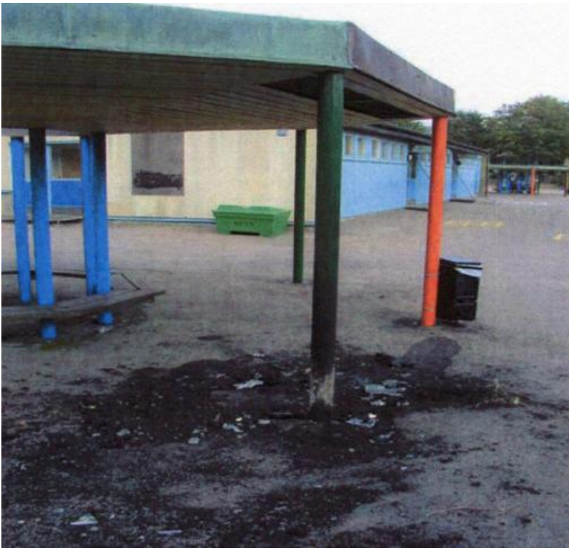
Skadorna på markbeläggning och byggnad.
