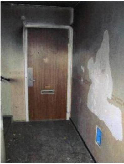
Rökspridning in i lägenhet via dörrkarm. Trapphusets skick och den saknade luckan.
