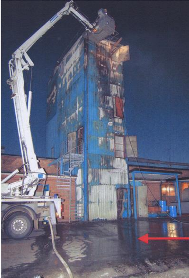
Brandskadorna sträcker sig över hela tornets höjd. På marken brann utflödande vätska utanför byggnaden.
