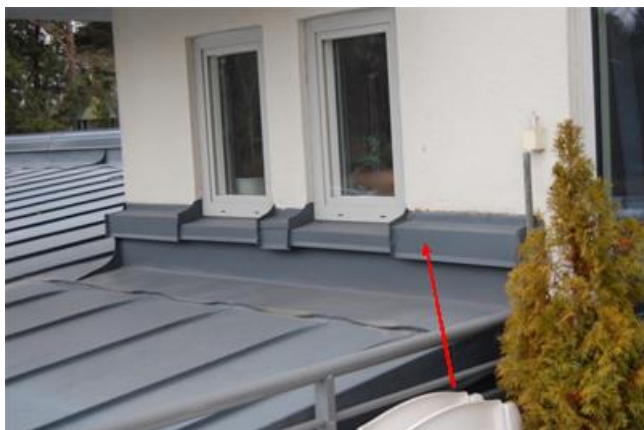
Så här såg plåttaket ut innan branden med plåtblecket. Under plåtblecket var ventilationsöppningen, (se nästa bild).
