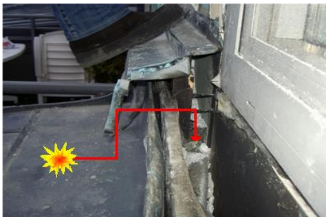
Det här är en rekonstruktion av hur plåtblecket satt och visar ventilationsöppningen där gnistor eller lågor från raketen tog sig in på krypvinden och antände frigoliten.
