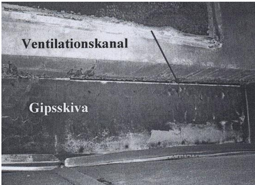
Fotot är taget rakt upp (ovanför fritösen/stekbord) och visar fläkten, ventilationskanalen och gipsskiva. Pilen pekar på glipan (0,5-1 cm) mellan gipsskivan och kanalen. Ventilationskanalen ligger dikt an mot bjälklaget.
