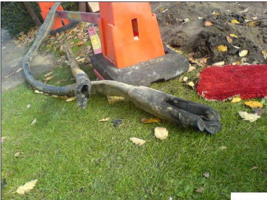
Kabelskarv där kortslutningen uppstod.
