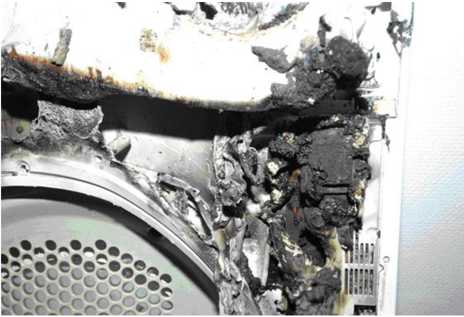
Till höger syns el-relä el.dyl som är brandskadat.
