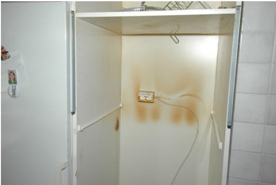
Lokal värmepåverkan på undersidan
