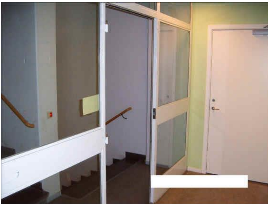
Borttagen dörr i trapphus.
