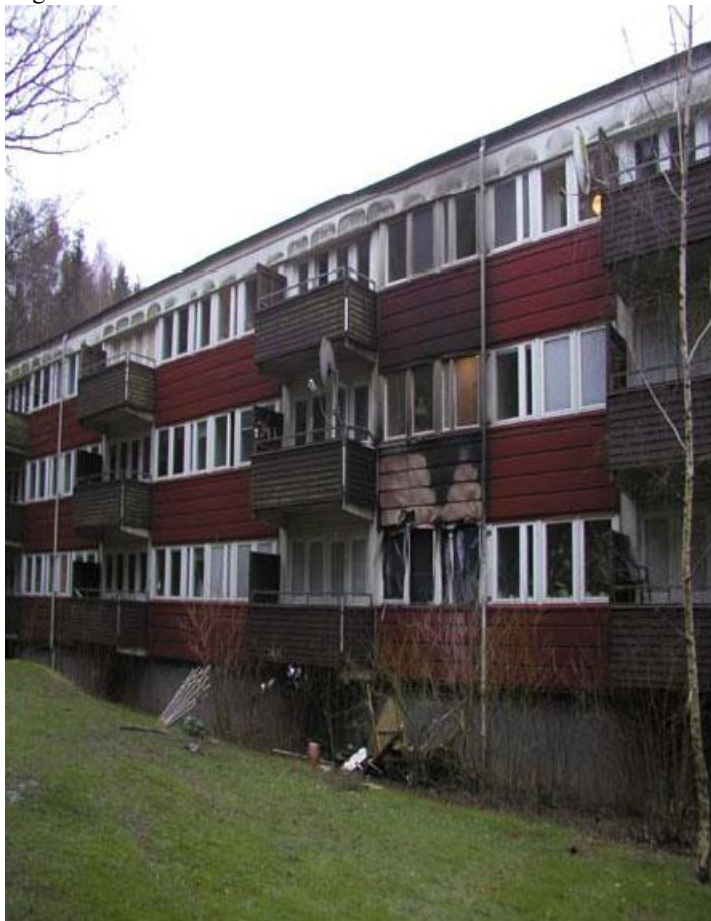
Den kraftigt brandpåverkade fasaden.
