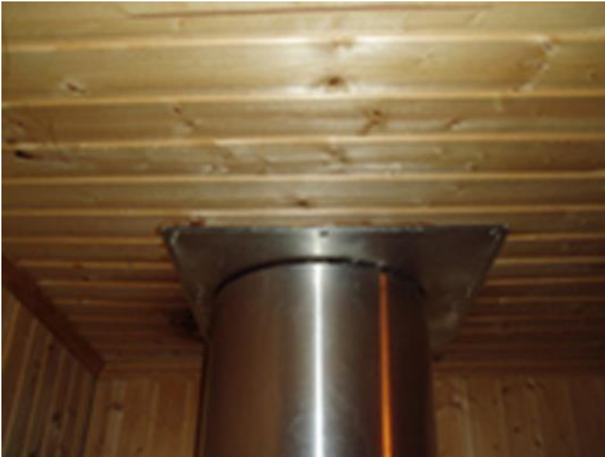
Basturörets överdel som går genom bastuns tak. Här upptäckte ägaren att det kom brandrök mellan plåten och taket.
