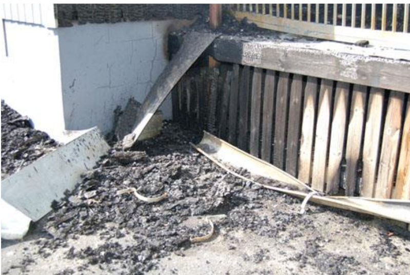
Lastkajens trä-sarg har brandskador ner mot marken. Skadorna tycks inte ha något direkt samband med övriga skador.
