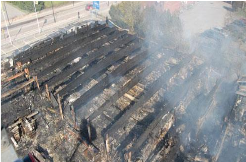
Översiktsbild över det totalskadade varuhuset
