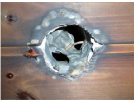
På 4 stycken kunde det konstateras kraftig värmeöverföring till takpanelen. Där även plastkopporna hade smält.
