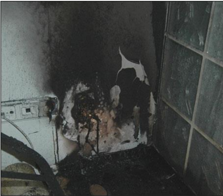
Figur 3 Närbild av uttaget där den brandskadade fjärrbrytaren/dimmern sitter
