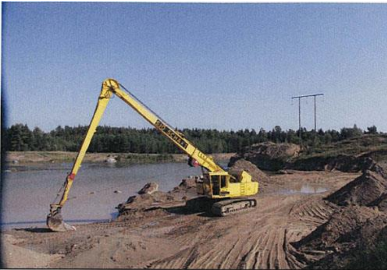
Grävmaskinen som var i beröring med ledningen
