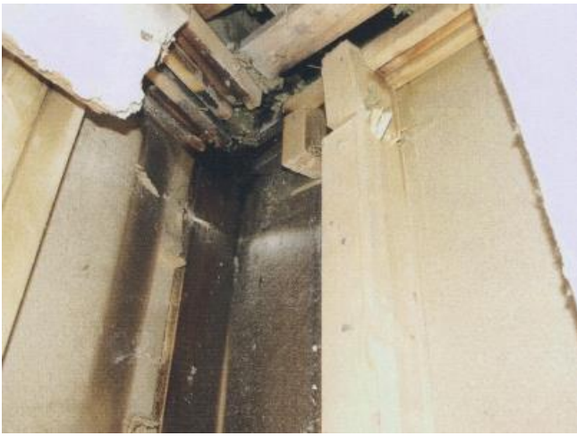
Brandskadan i övre delen av väggen bakom spisen.
