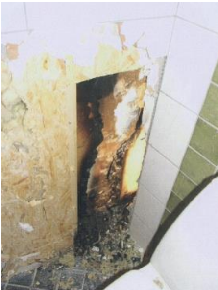
Brandskadan i väggen mot toaletten. Räddningstjänsten har sågat upp väggen.
