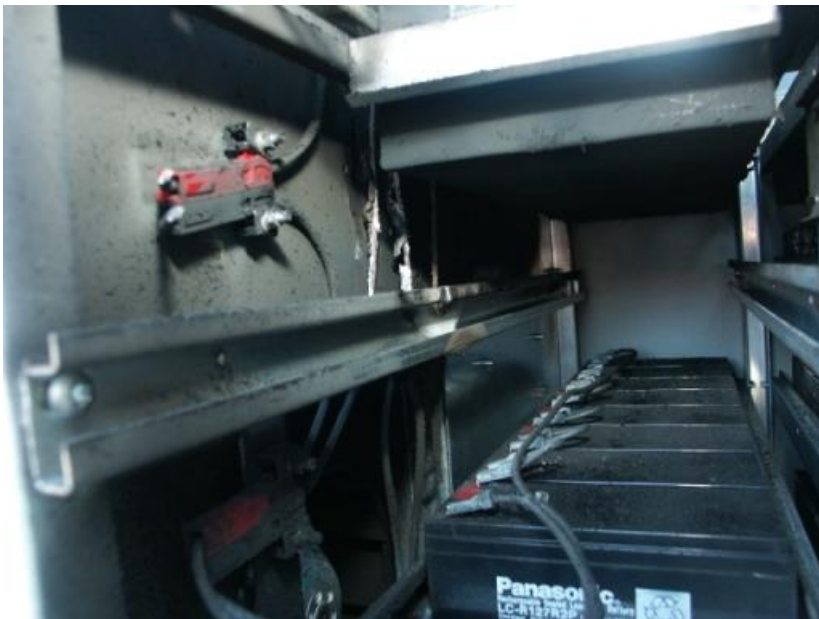
På bilden syns kortslutningsskador som synes vara primära. Batteripaket som brunnit är utdraget ur sina skenor.
