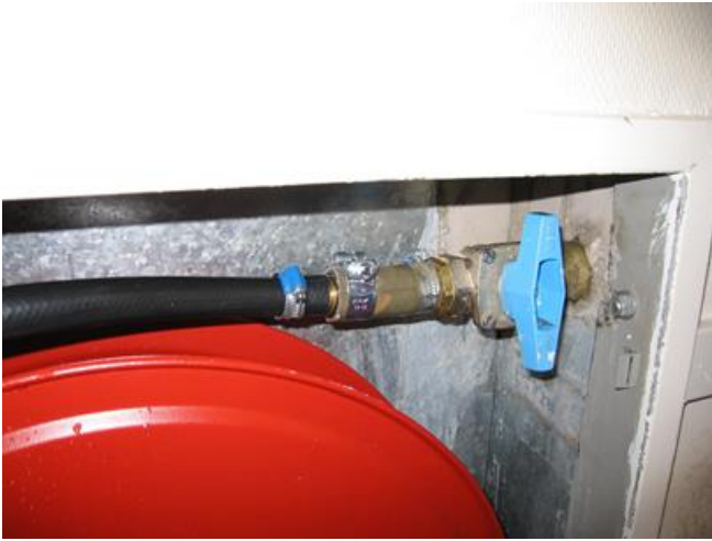
Slangklämma som lossnade när rullen användes
