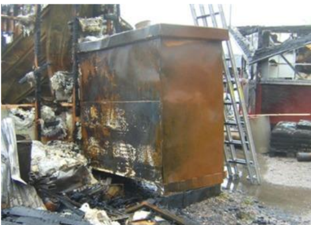
Gasolskåpet som stått placerat mot affärens västra fasad. Skåpet står kvar på sin plats med fasaden är borta.
