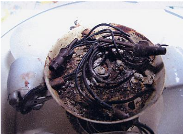
Lampan med dess kablar visar att kablarna är hela i lampan,
