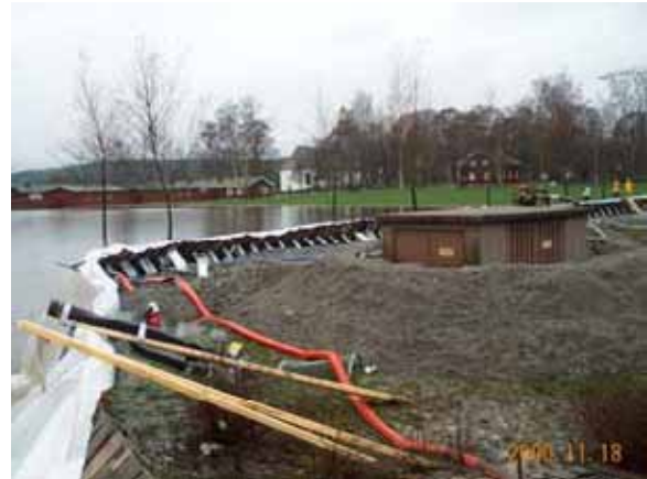
Transformator på Sjögatan 2000-11-18
