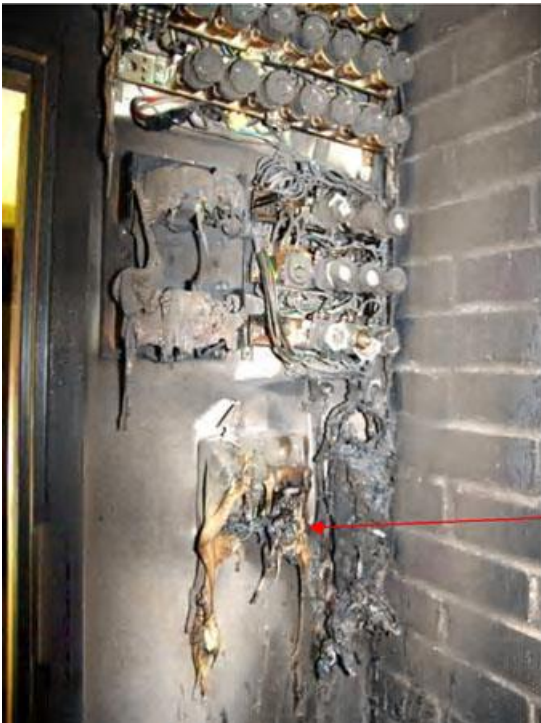
Pilen visar resterna av jordfelsbrytaren.
