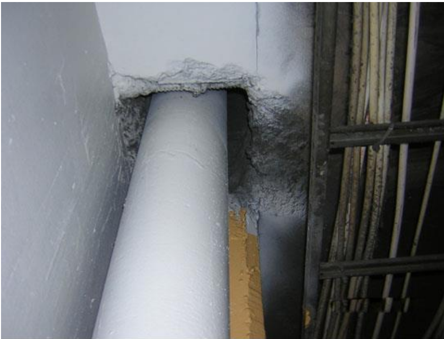
I den här öppningen i bjälklaget mellan lastkajen och gången i parkeringsgaraget läckte röken ut.
