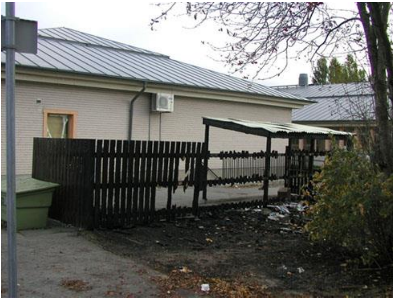
En ganska stor anläggning som innehållit mkt brännbart
