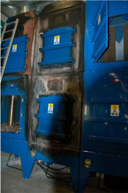
Primärbrandplatsen utgörs av filter 2, brandspridning till intilliggande filter
