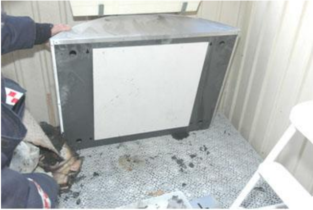
Spisens baksida. Räcker mineritskivan som skydd mot värme till väggen?
