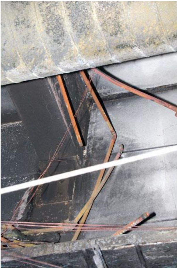
Kopparledningar i fatlagret har deformerats och släppt i skarvar.
