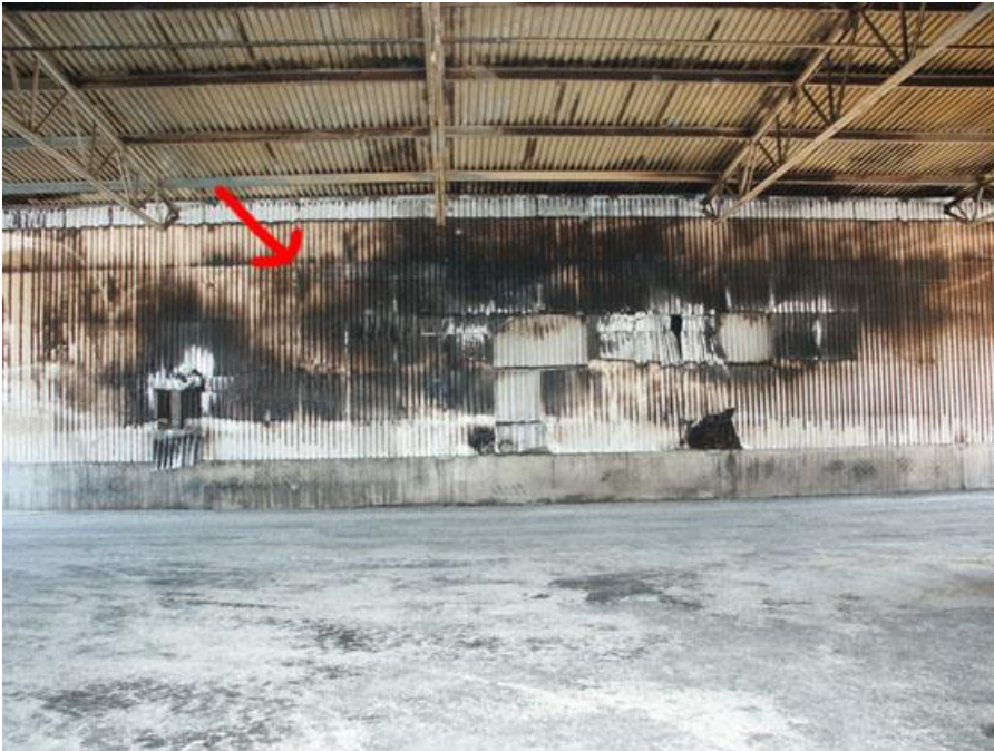
Tecken på "ytflamspridning" i dammlagret på innerväggar i plåt. Även i taket finns spår.
