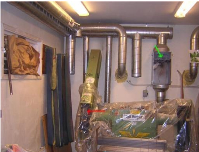
Gröna pilen visar filtret där branden började. Röda pilen visar maskinen där slipning skedde som orsakade branden.
