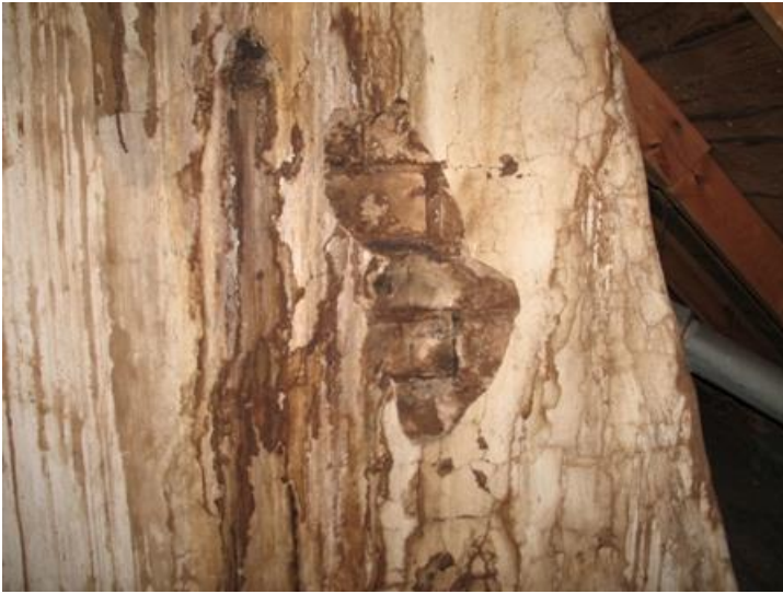
Här syns skadan på murstocken, i mitten är tegelstenen som kan tas ut för hand. Mellan tegelstenen kan man se rakt in till rökkanalen.
