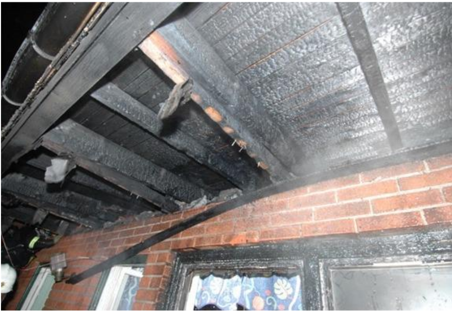
Brandspridning till taket.
