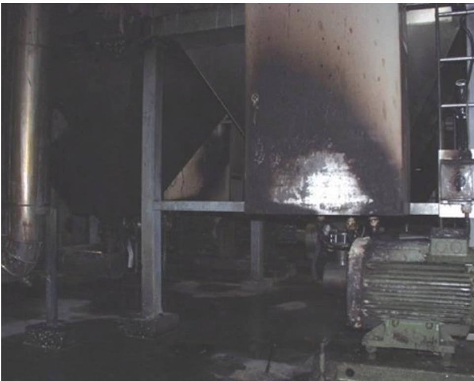
Nedfallna rester av trädäck och plast har via bl a kablage spridit branden mellan process-tankarna mot styrskåp vid pump B.
