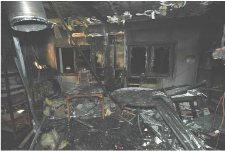
Brandskadat klassrum. Brandgaser trängde in i rummet och antändes i taket.
