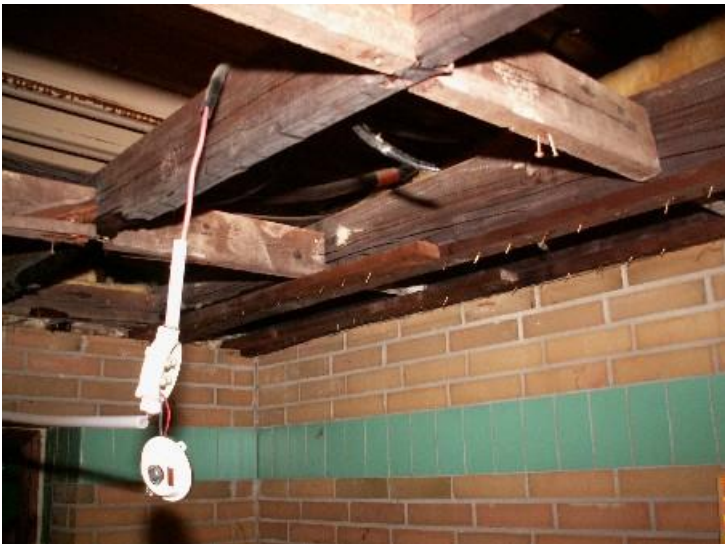
Kolningsskador på träregelverket ovanför taket.
