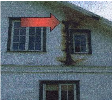
Blixten följde elledningarna och antände fastigheten. På bilden syns var ledningarna gick in i huset.
