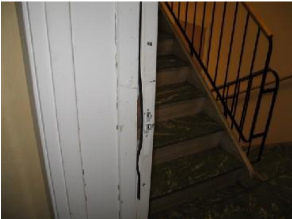
Bilden tagen på lägenhetens entrédörr mot trapphuset. Dörrens infästning har gett vika av övertrycket i lägenheten.
