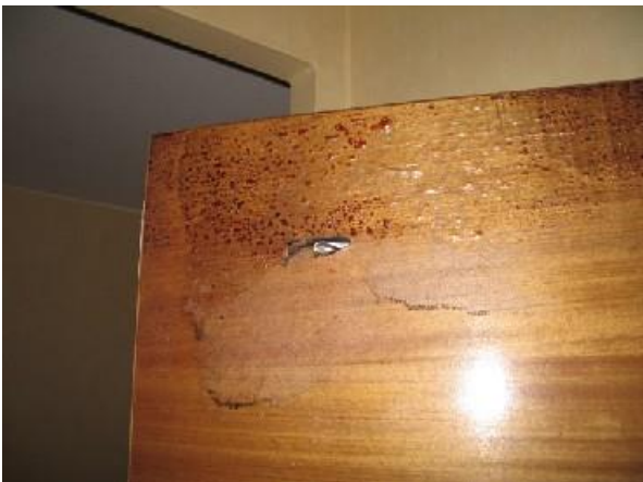
Toalettdörrens överkant har värmeskador, samt en botten av en sprayburk som sitter i dörren.
