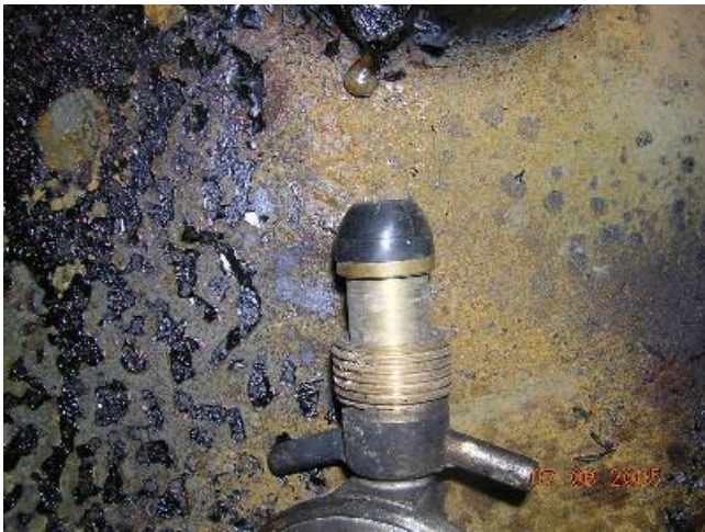
Gummikonan som skall täta i flaskventilen. Synliga sprickor finns.
