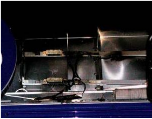
Innanför skyltfront med brunna kablar och elkomponenter
