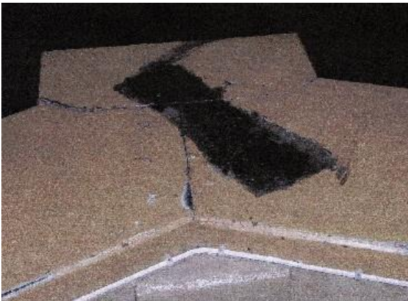
Liten skada uppstod, ett 5 mm djupt brännmärke.
