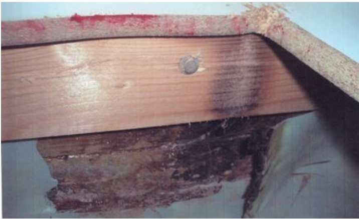
Läckage från schaktet under kastrullskåpet, där det fanns risk för brand- och rökspridning.
