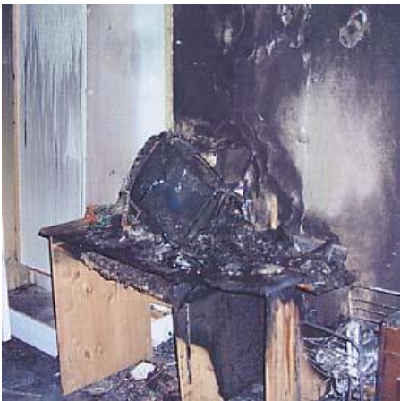
Datorplatsen i vardagsrummet där branden börjat.
