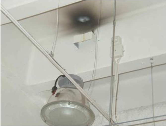
Det är troligen liten luftväxling inuti balken där styrenheten är placerad.
