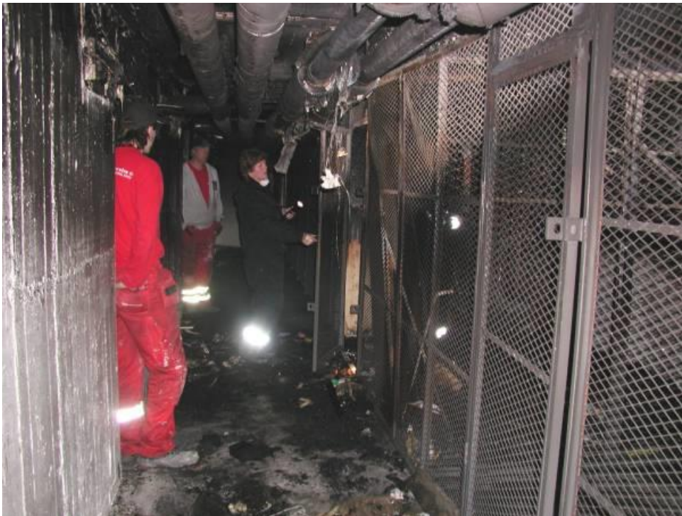
De två direkt brandutsatta källarförråden. Hela källarvåningen blev helt nedsotad, en rengöringskostnad av dignitet väntar!
